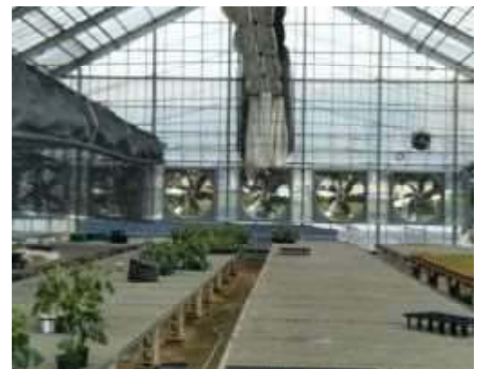
反対側の側面に設置されたファン
